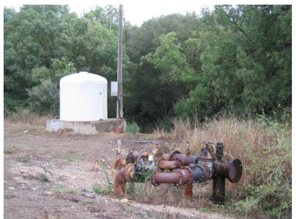
Figura 20 – Captação de água a 1 km jusante de D1.
